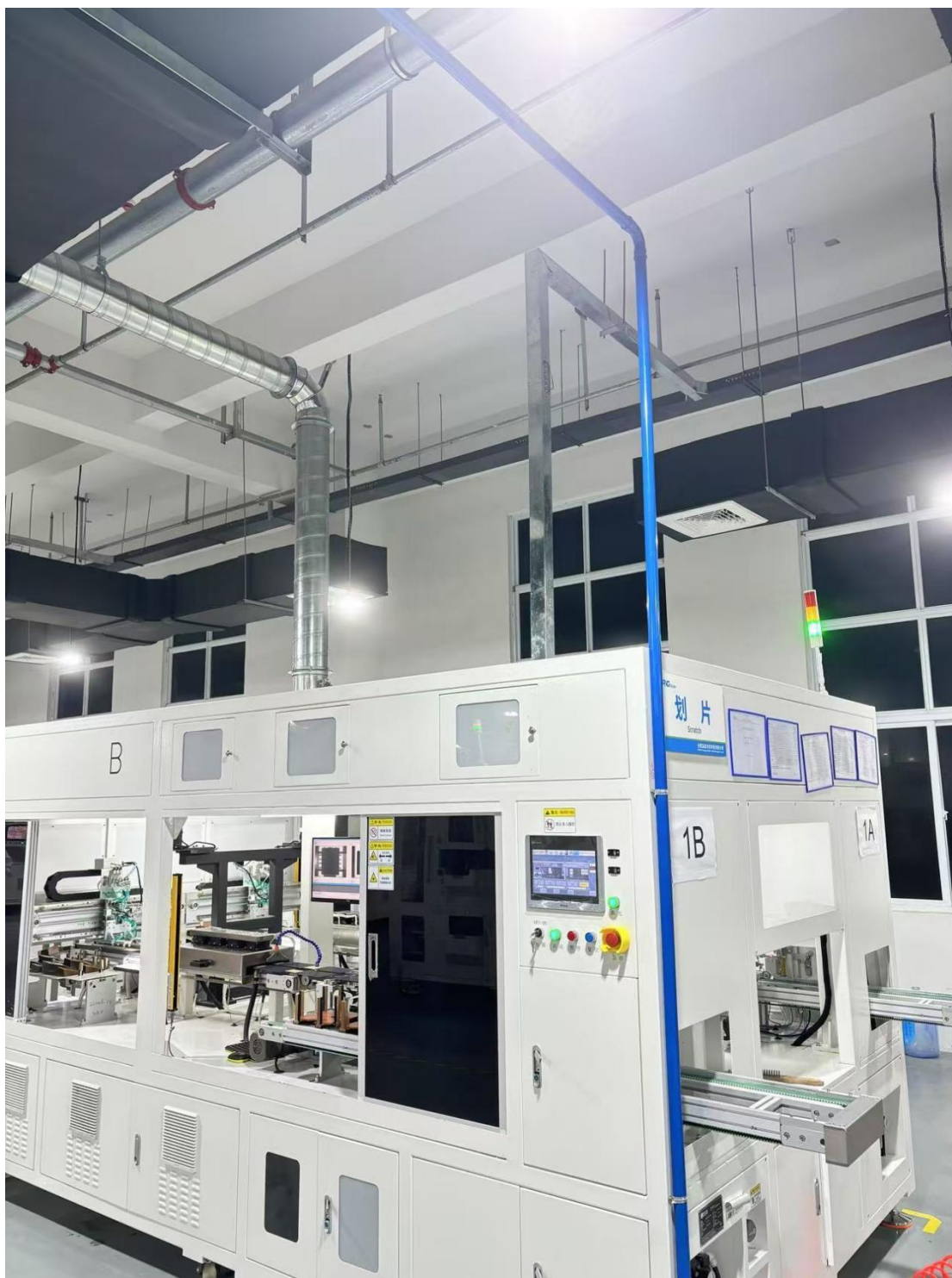
划片粉尘集尘管道
