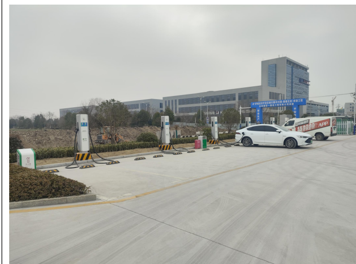
停车场充电桩区域
