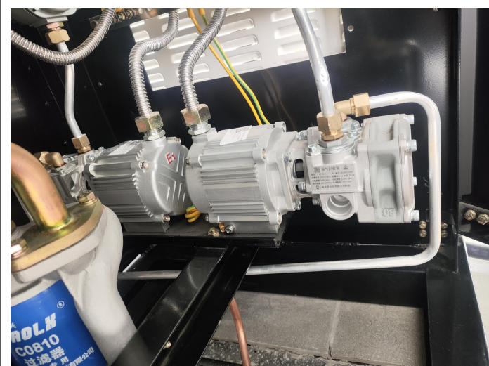
加油油气回收装置
