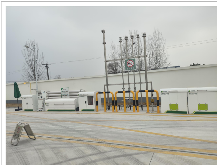
卸油区及消防沙箱
