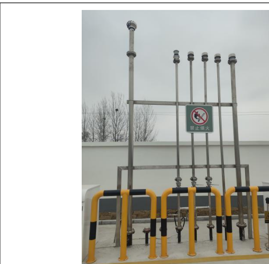
卸油油气回收装置
