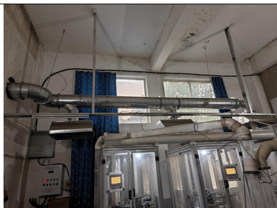
废气收集管线
