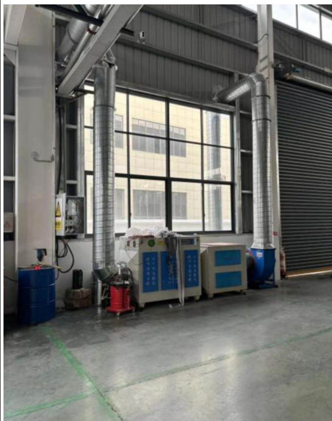
UV 光氧废气处理设施+活性炭吸附装置
