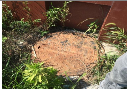
生活污水接管位置
